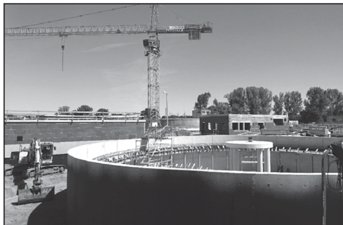
Oczyszczalnia – osadnik wtórny. W tle reaktor biologiczny, budynek technologiczny, osadnik wstępny
