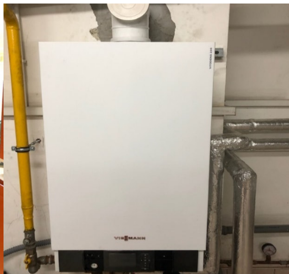
Fot. Piec gazowy w Przychodni w Kolumnie
